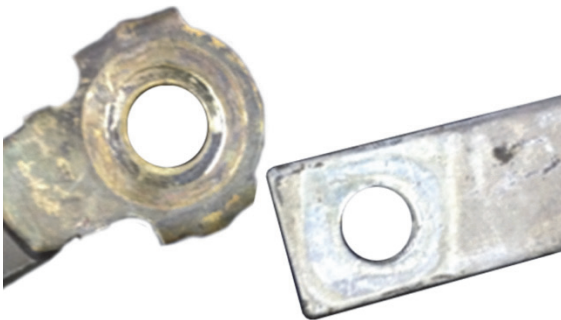
Fig. 1: Ligação da massa antes da limpeza: mau contato
