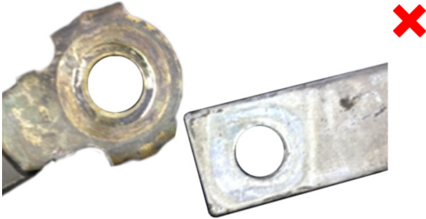
Fig. 1 : Mise à la terre avant le nettoyage : mauvais contact
