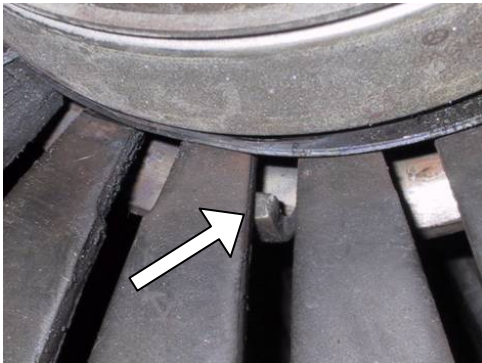
Slika 1: poškodovan sedež vodilnega čepa potisnega obroča – čep je zdrsnil pod membransko vzmet
