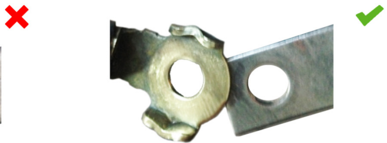
Εικ. 2: Σύνδεση γείωσης μετά τον καθαρισμό: καλή επαφή
